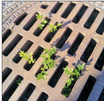
Abb. 9: Junge Eschen ( Fraxinus excelsior ) in einem Kanalschacht in Tumeltsham – im Dauerstress durch ständiges Geköpftwerden!
